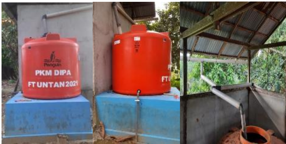
Gambar 6 Instalasi Penampungan Air Hujan: (Kiri) Tampak Depan, (Tengah) Tampak Samping, (Kanan) Instalasi Pipa Ke Tandon Lain
