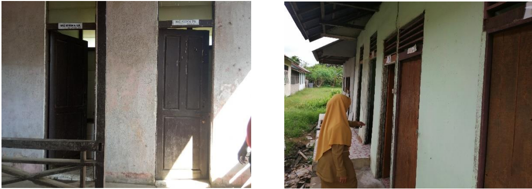
Gambar 5. (a) kondisi jamban di SD Negeri 16 Rasau Jaya, (b) kondisi jamban di SD Negeri 02 Rasau Jaya
